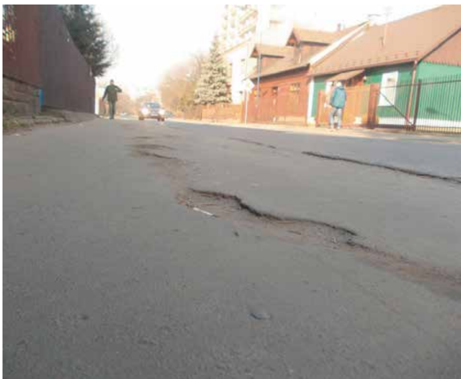
Czekający na remont chodnik przy ul. Ślicznej. Fot. Mateusz Drożdż
